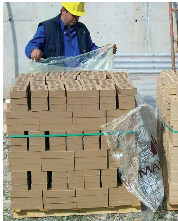
Retirada del plástico al paquete de ladrillos al menos 3 días antes de su colocación. En la imagen se puede apreciar la diferencia de color entre un paquete húmedo y otro con varios días desembalado.
