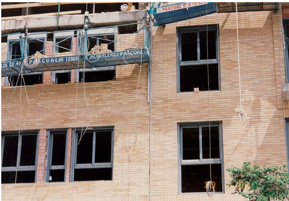
Ladrillo en fase de colocación. En la imagen se ven claramente los desentones producidos por la humedad.
